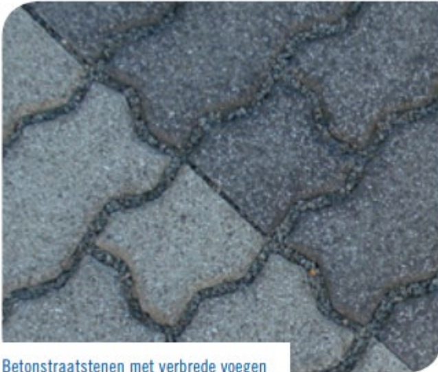
Betonstraatstenen met verbrede voegen
